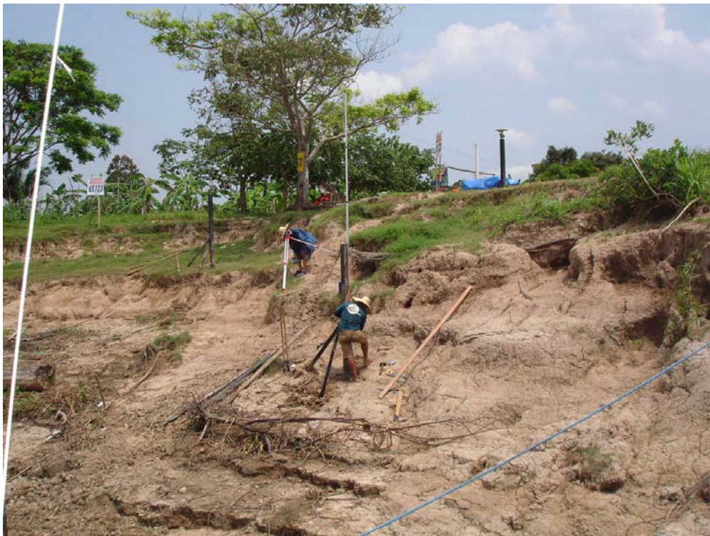
Figura 6.7- Forte erosão que afeta as seções de réguas linimétricas e o nivelamento geométrico.
