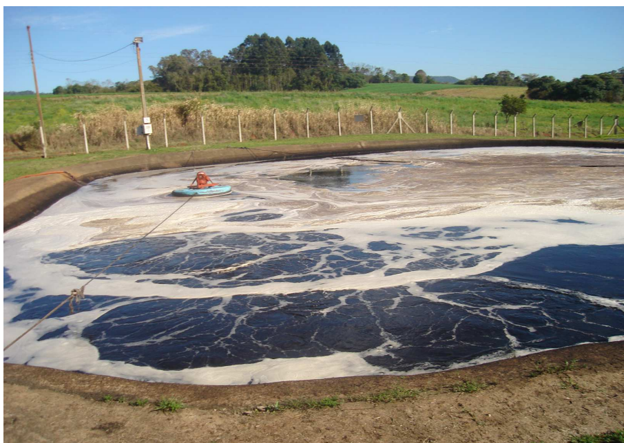
Figura 2 - Estação de tratamento de efluente do aterro sanitário de Lajeado - bairro Conventos (Fonte: SEMA).
