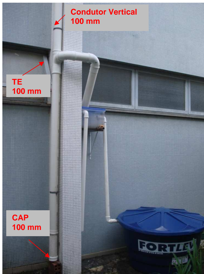
FIGURA 16 – EQUIPAMENTOS CONDUTORES DA ÁGUA DE CHUVA FONTE: O AUTOR (2010)
