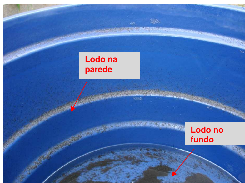
FIGURA 30 – LODO ACUMULADO NO RESERVATÓRIO NA FASE INICIAL DA PESQUISA FONTE: O AUTOR (2010)
