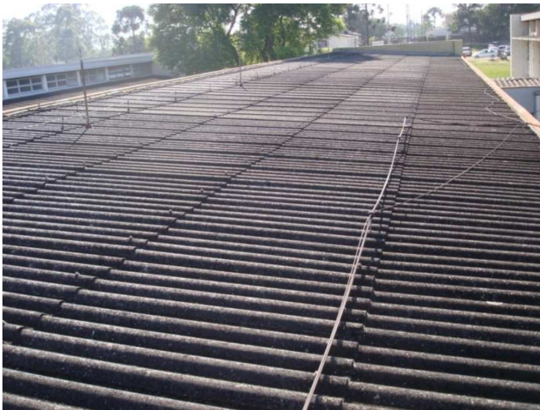
FIGURA 13 - SUPERFÍCIE DE CAPTAÇÃO FONTE: O AUTOR (2010)
