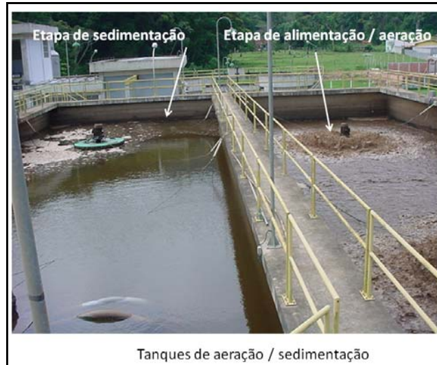
Figura 44. Vista parcial dos reatores da ETE Boiçucanga
