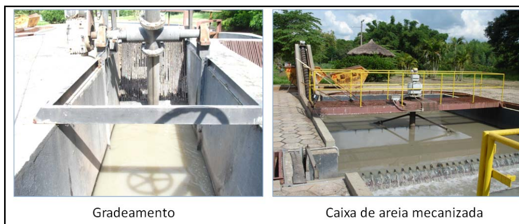
Figura 35. Visa do gradeamento e caixa de areia da ETE Tupã - SP
