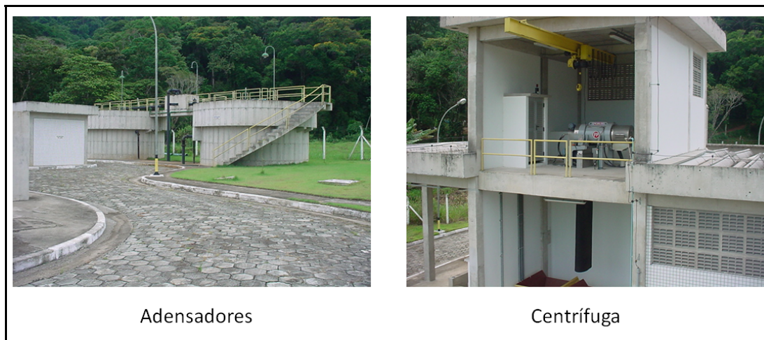
Figura 46. Vista dos equipamentos que compõem a fase sólida da ETE Boiçucanga
