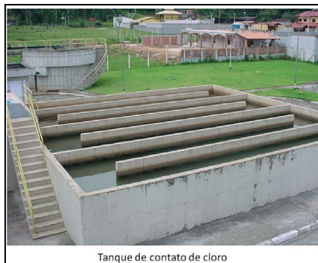
Figura 45. Vista do sistema de desinfecção do efluente da ETE Boiçucanga
