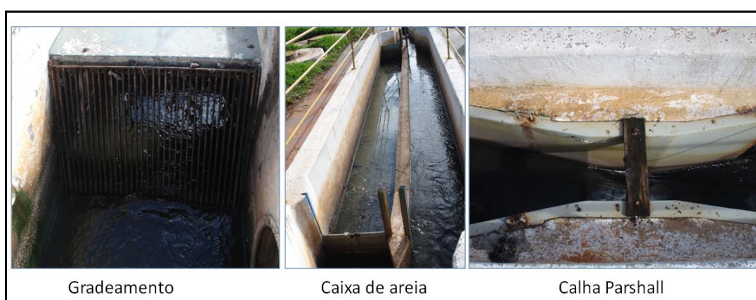
Figura 53. Elementos que compõem o tratamento preliminar da ETE 2 Fernandópolis
