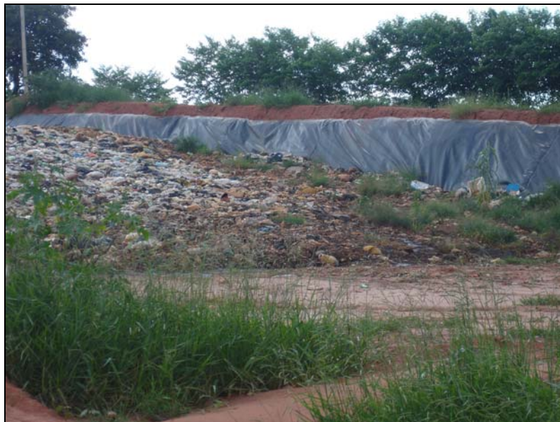
Figura 17. Célula de resíduos do aterro sanitário de Tupã
