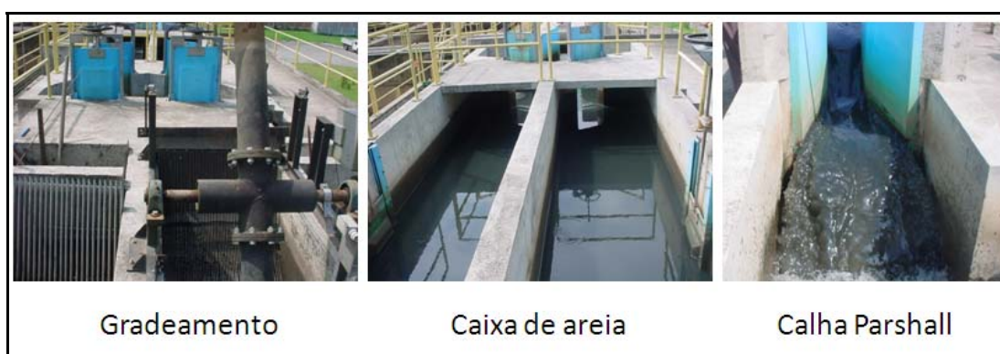
Figura 43. Vista dos equipamentos que compõem o tratamento preliminar da ETE Boiçucanga
