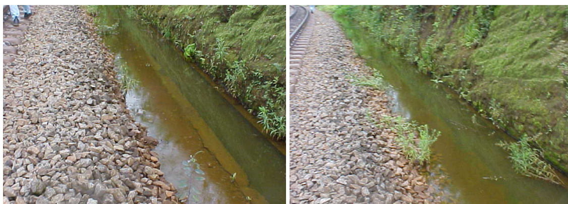
Figura 5.5 – Falhas na drenagem (região do Pátio 5 da EFVM): sublastro e lastro saturados.
