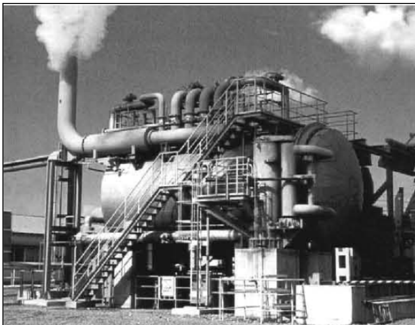
Figura 2.5 – Autoclave desenvolvido pelo Japão para cura de escória de aciaria com vapor d'água a alta pressão (Silveira, 2004).
