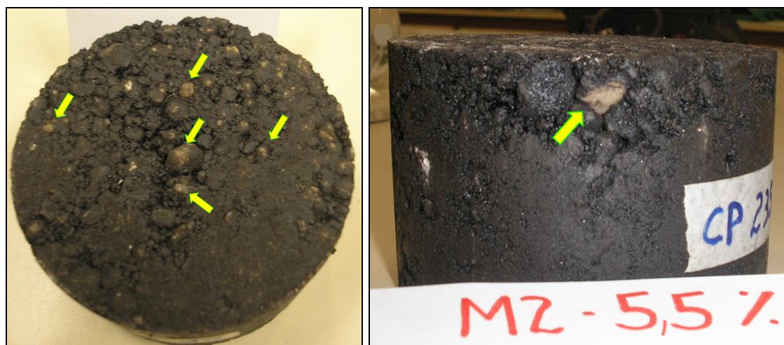
Figura 4.7 – CP apresentando agregados com recobrimento insuficiente de ligante indicados pelas setas para a mistura M2 no teor de 5,5%.
