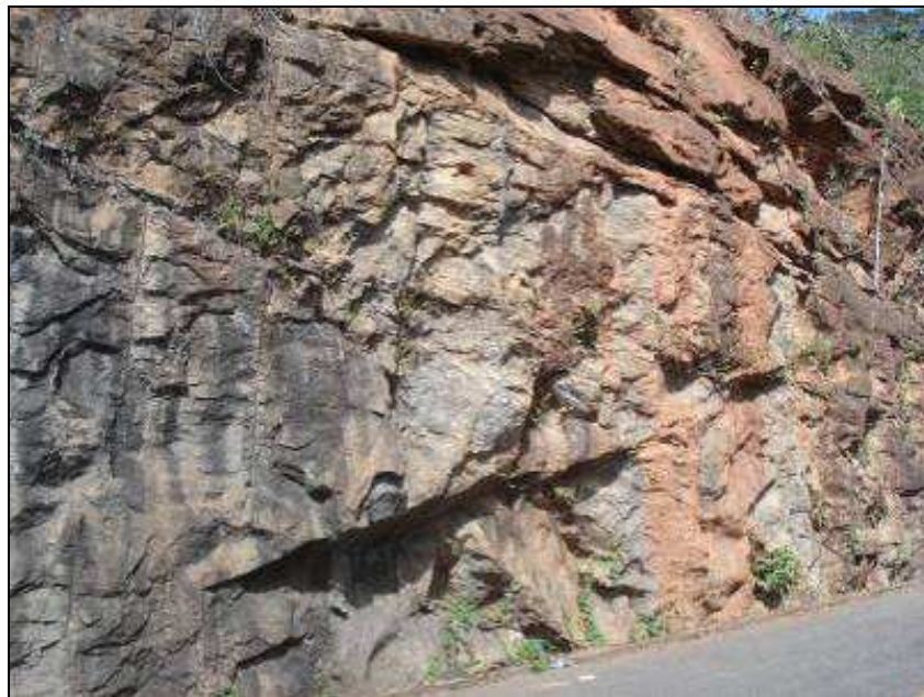
Figura 4.17 – Detalhe do estado de fraturamento do talude ES-355.
