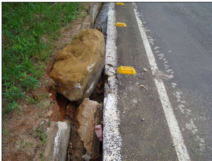
Figura 6.2 – Destruição de canaleta de drenagem no pé do talude ES-146 devido à queda de bloco.
