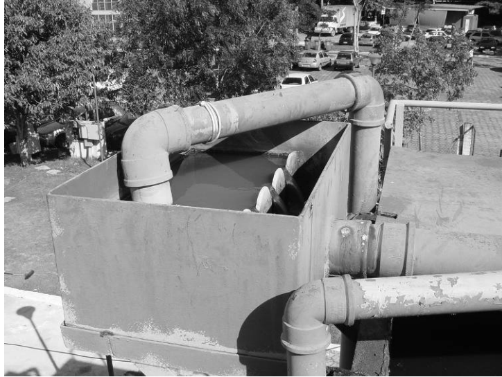
Figura 4.3 – Caixa de areia (entrada UASB)
