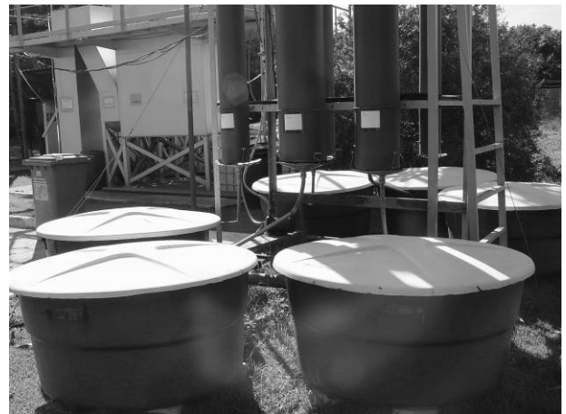
Figura 4.11 – Reservatórios de coleta de efluente
