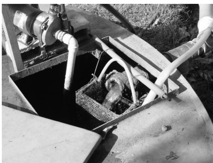
Figura 4.2 – Gradeamento (cesto removível) – Entrada ETE/UFES
