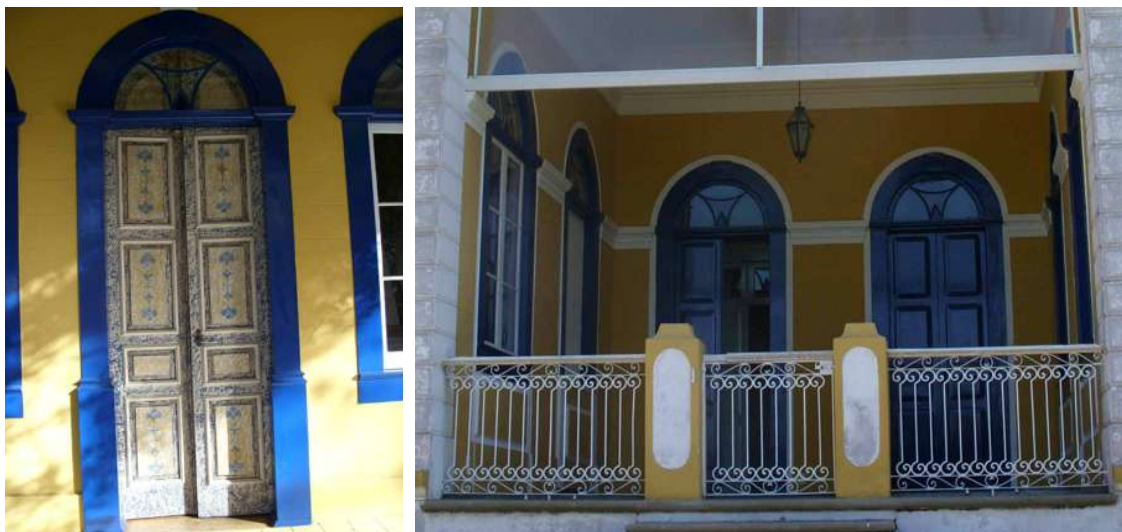
Figura 95 e 96: Portas da sede alta na fachada frontal em arco pleno com bandeira e na fachada posterior portas igualmente em arco pleno e com bandeira
