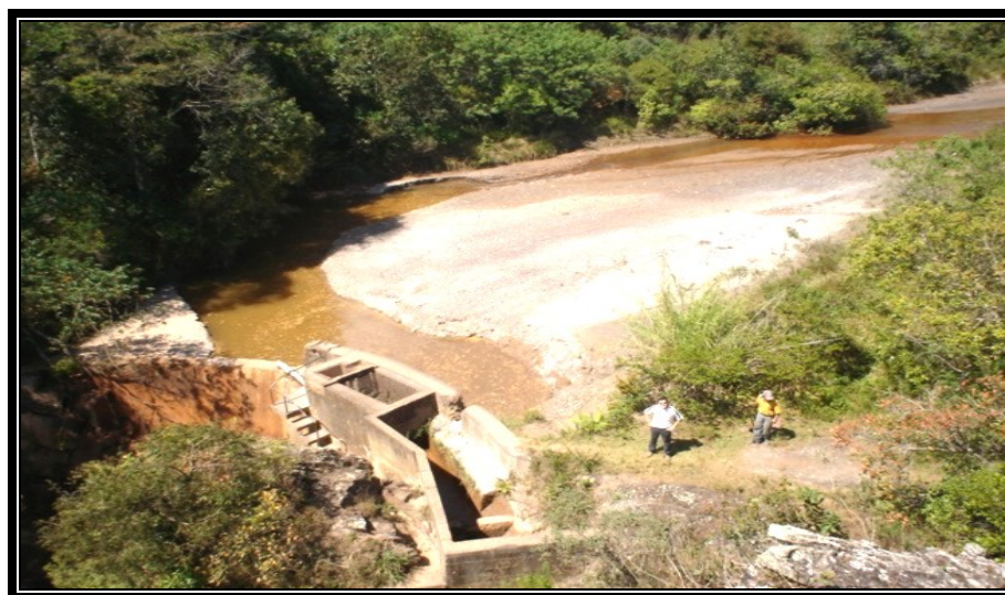
Figura 5.4.2: Assoreamento na ETA Vila Alegre
