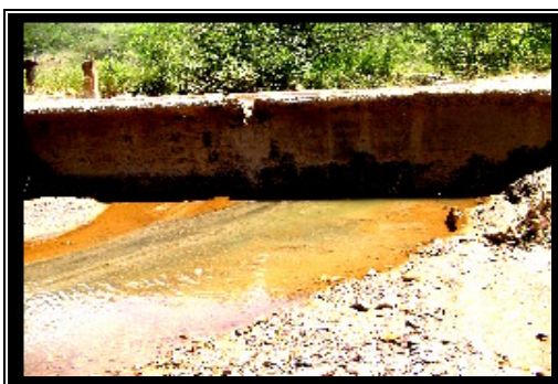
Fig. 5.2.9: Ponte/C. Cipó assoreado
