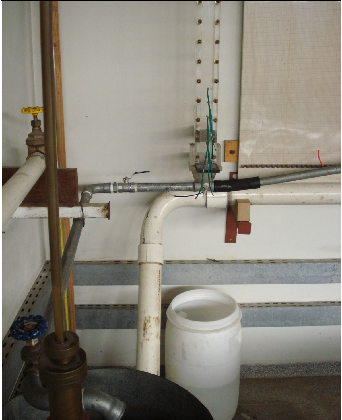
FIGURA 4.6 – Dispositivos de Jusante e Válvula de Fechamento Rápido.
