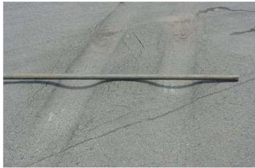
Figura 3 – Afundamento em trilha de roda
