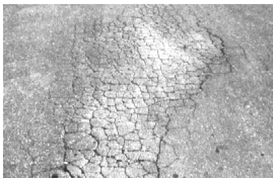
Figura 2 – Trincamento por fadiga
