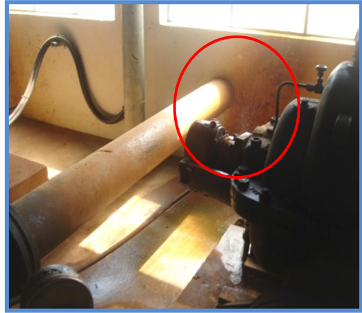
Figura 25 – Conjunto de bombas do SiTA E. (No detalhe perdas físicas)
