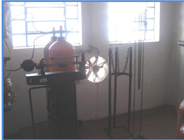
Figura 39 – Recinto para armazenamento de cloro gasoso na ETA 1 do SiTA E.
