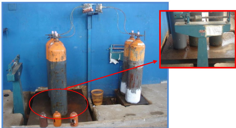
Figura 40 – Recinto para armazenamento de cloro gasoso na ETA 2 do SiTA E, no detalhe cilindros sobre área úmida.
