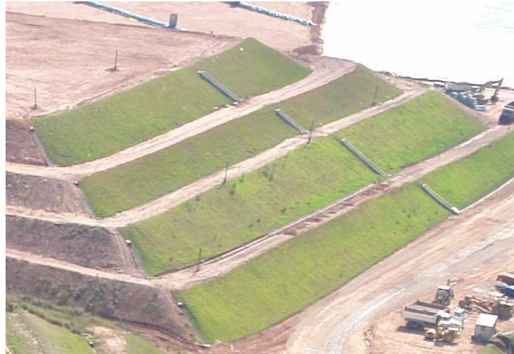
FIGURA 3.5 – VISTA DAS CÉLULAS SOBREPOSTAS E DO SISTEMA DE DRENAGEM DE ÁGUAS PLUVIAIS
