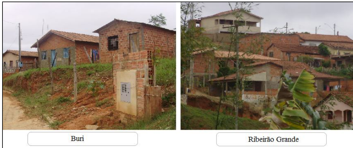
Figura 19: Auto-construção da moradia em Buri e Ribeirão Grande. Fonte: Orlando Moreira Junior, trabalho em campo, 2009.
