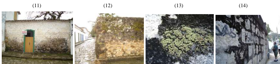
(11) Ataque de bactérias e fungos na cidade de Parati - RJ
