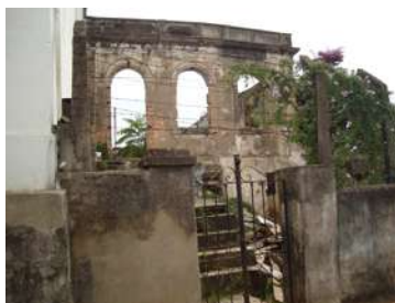
Casa abandonada em tijolo maciço em Ouro Preto – MG
