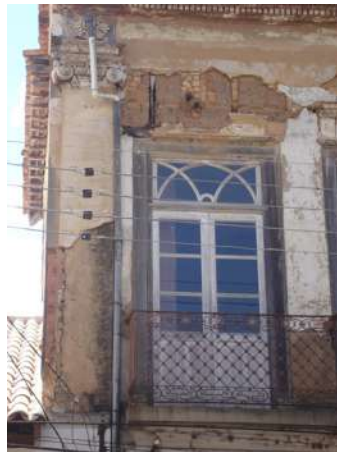
Ataque de fungos, plantas e cupim de solo em casa na Praça da Matriz Bananal – SP
