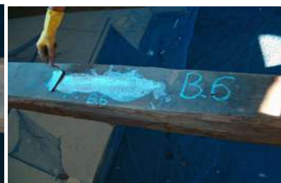
Consolidação do local do ninho com resina
