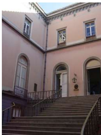
Ataque de fungos, bactérias e pombos argamassa pozolânica, pátio interno do Museu Nacional – Rio de Janeiro – RJ
