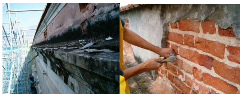
Ataque de fungos, bactérias, líquens e plantas tão agressivo que as argamassas estavam totalmente comprometidas e tiveram de ser substituídas, platibanda do pátio interno do Museu Nacional – Rio de Janeiro - RJ
