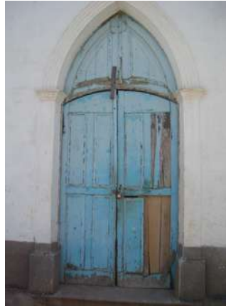
Ataque de cupins de madeira seca em porta da Santa Casa – Bananal - RJ
