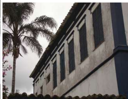
Ataque de fungos e bactérias e pintura calcinada Sede da fazenda alterosa, Penido, distrito de Igrejinha – Juiz de Fora – MG
