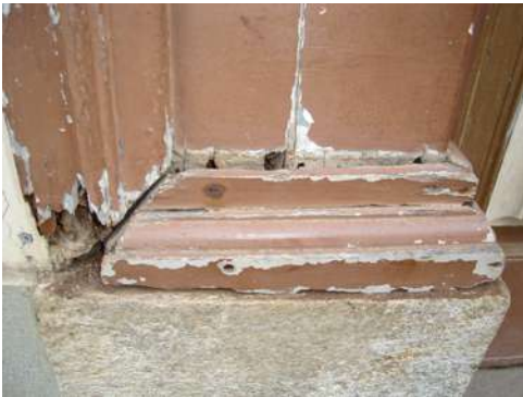
Ataque de fungos e térmitas em porta secundária da Igreja de N.S. da Conceição – Duas Barras – RJ
