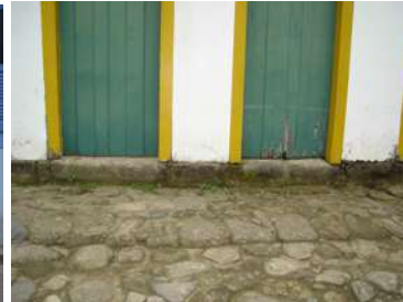
Ataque de fungos em porta na cidade de Parati – RJ
