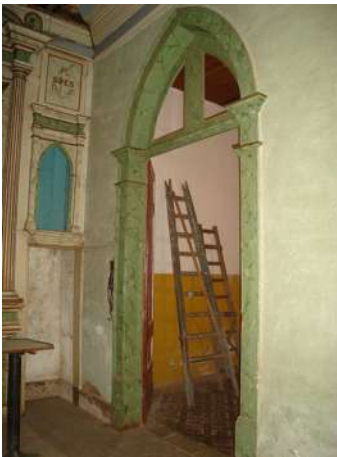
Ataque de cupim de madeira seca na Capela da Santa Casa – Bananal – SP
