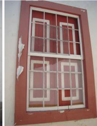
Ataque de fungos em janela por falha da pintura, Santa Casa – Bananal - RJ
