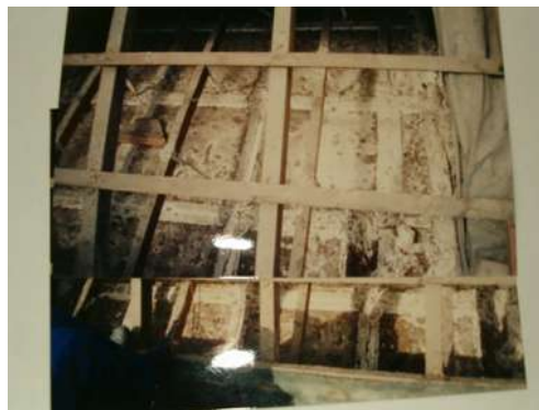
Fixação de forro de estuque através de fasciados de madeira e trama estrutural - 2º andar da exposição do Torreão Norte Museu Nacional – Rio de Janeiro - RJ
