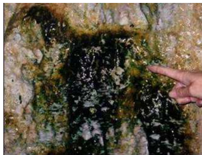
Muro interno do Museu Imperial de Petrópolis - RJ (vazamento de tubulação subterrânea)
