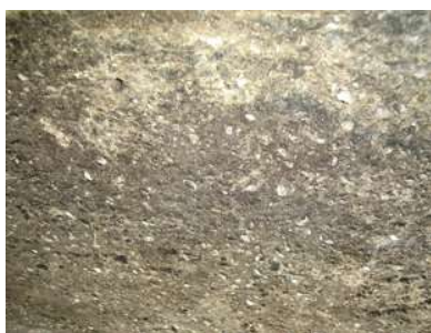
Ataque de fungos, bactérias e líquens argamassa a base de cal de marisco, Igreja dos Jesuítas – São Pedro d'Aldeia – RJ
