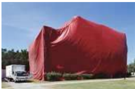
edificação coberta com encerado em teste realizado na Califórnia – USA
