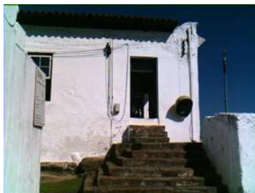
Fortaleza da Barra, restaurada em 2005 instalações e serviços públicos pendurados pelas paredes da fortificação - Santos – SP
