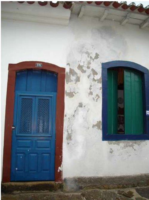
Porta parcialmente substituída devido ao ataque de fungos bactérias e cupins – Parati – RJ
