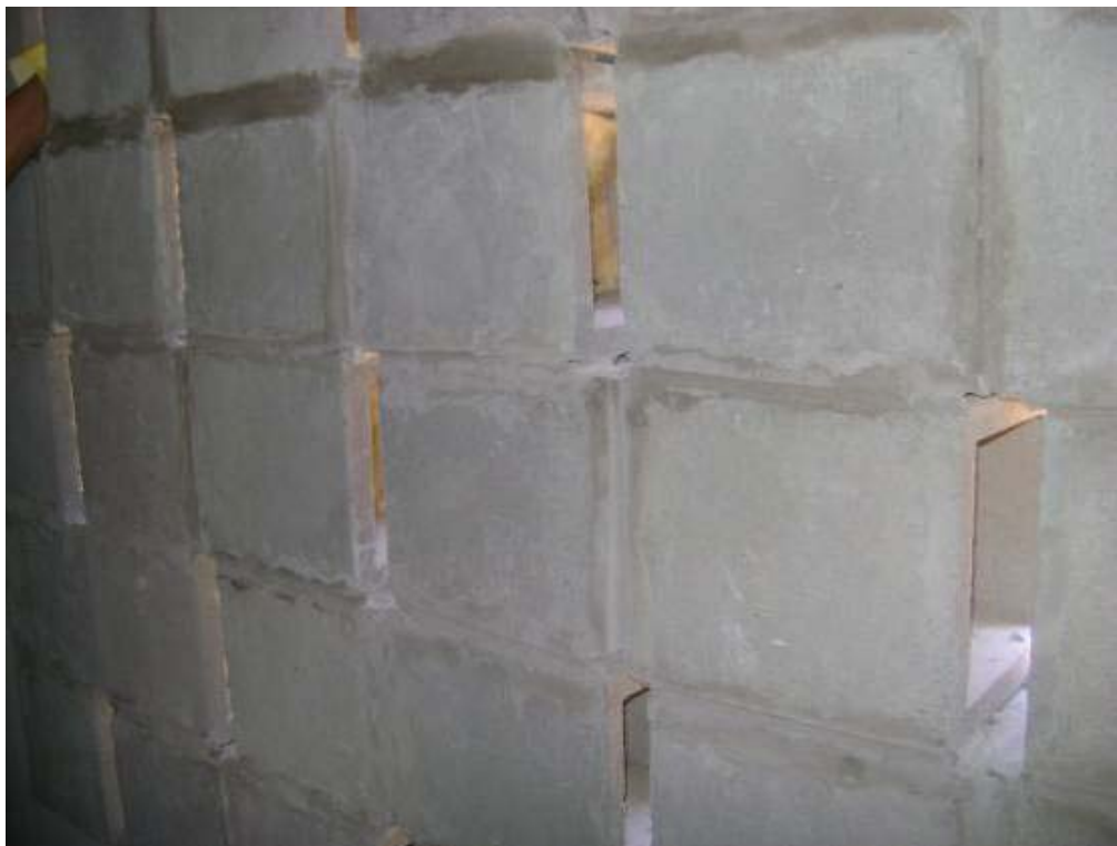
Figura 66. Foto da parede de teste montada com o bloco tipo 2, espaçado de 5cm e com lã de vidro nas cavidades (G5c/lã)
