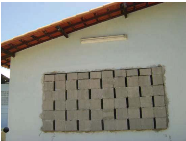
Figura 62. Foto da parede de testes montada, com aberturas de 5 cm, com o bloco tipo 2, sem lã de vidro (G5s/lã)
