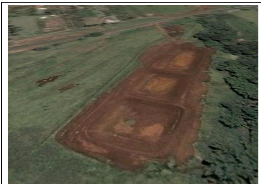
Figura 9: Imagem da obra de escavação das lagoas de tratamento de esgoto - Foto: Google Earth 2008.
