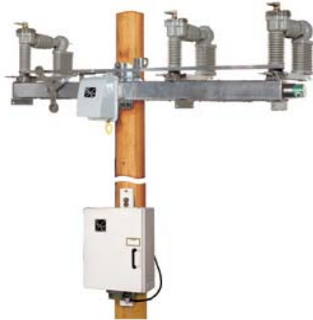
Figura 2.16 – Chave de manobras tripolar de operação remota.
