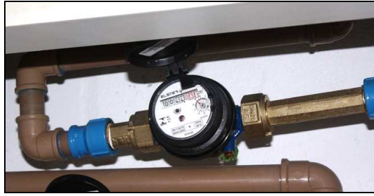
Figura 31: Hidrômetro da área de lazer
