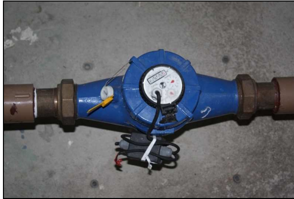
Figura 29: Hidrômetro na entrada da ETAC
