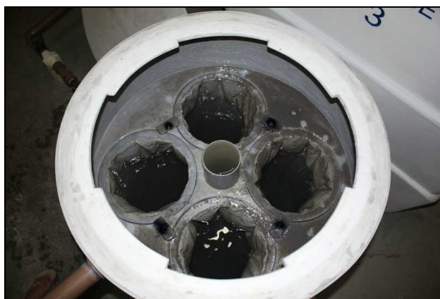
Figura 25: Interior do filtro terciário
