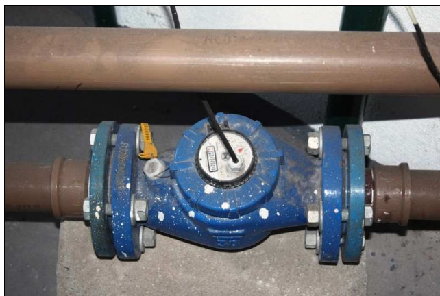
Figura 30: Hidrômetro da coluna de alimentação de água de reúso
