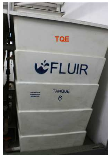
Figura 23: Tanque de equalização
