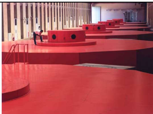
2. Geradores da usina
