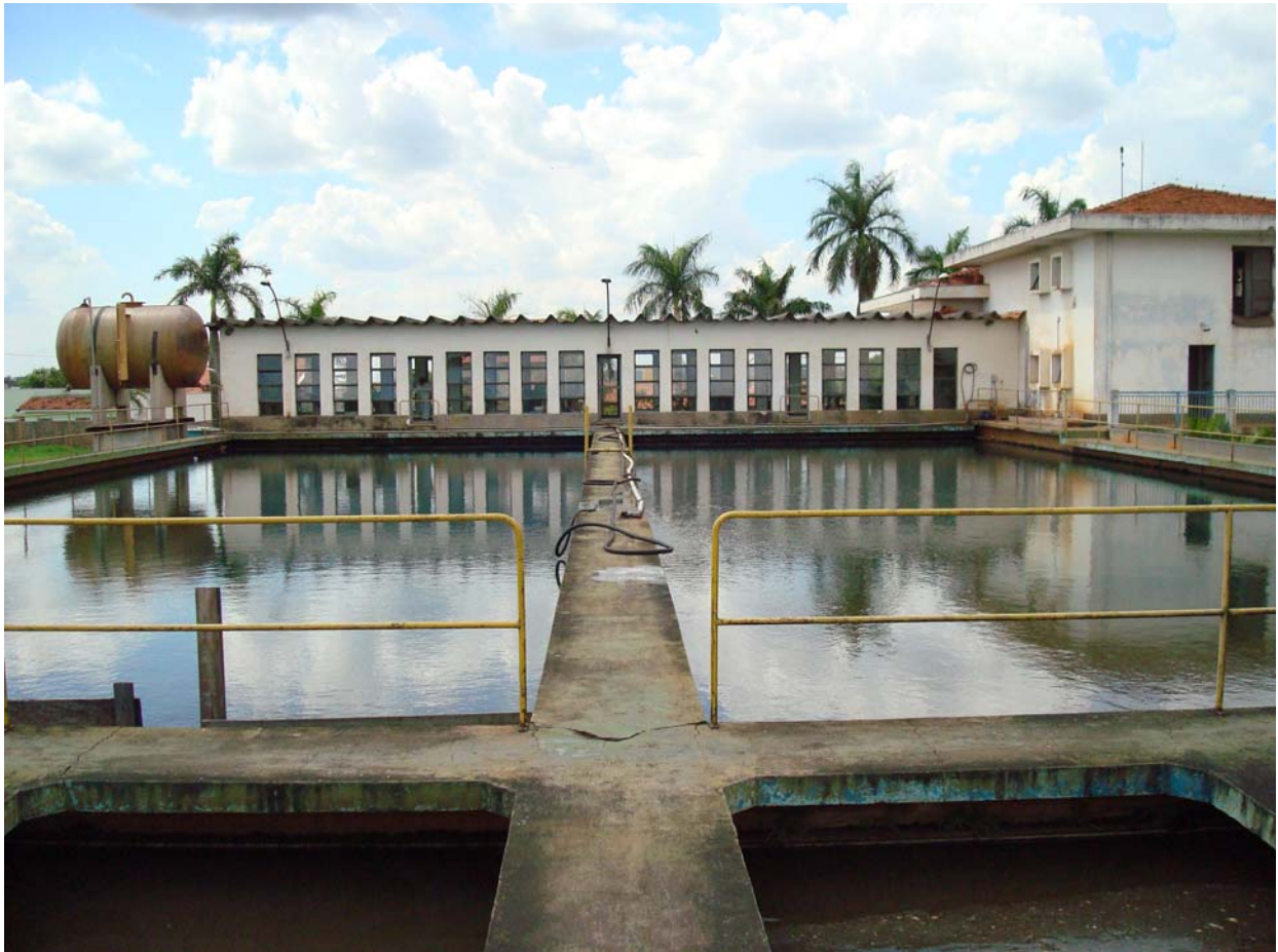
Figura 4.6 – Foto dos decantadores da ETA 3.
