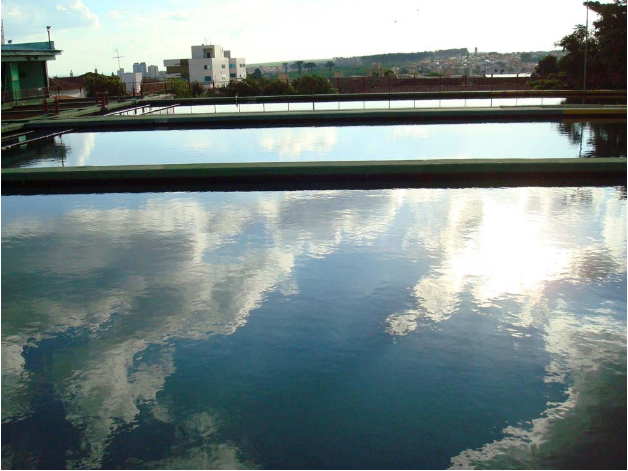
Figura 4.4 – Foto dos decantadores da ETA 1.
