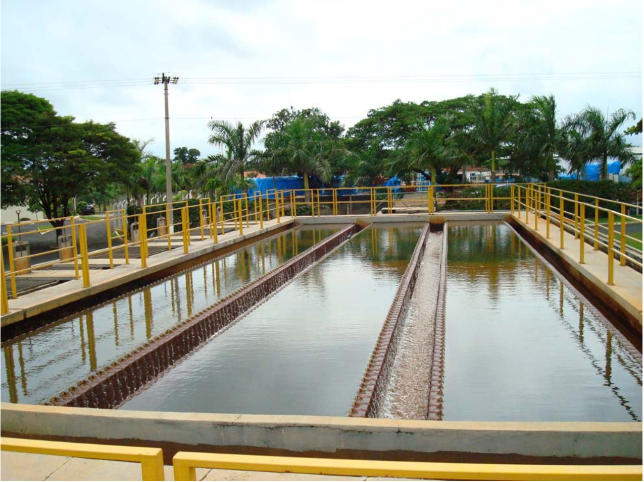
Figura 4.5 – Foto dos decantadores da ETA 2.
