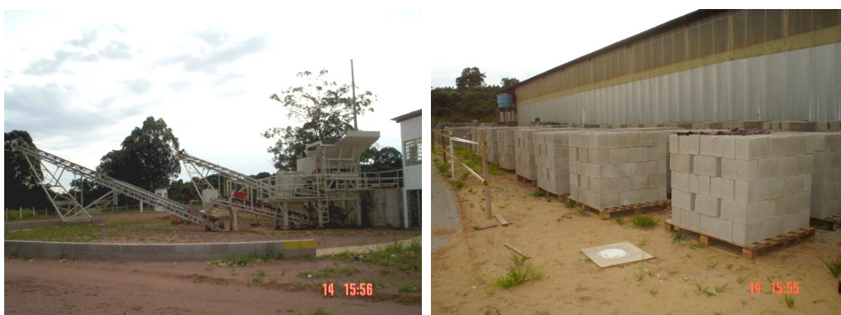
FIGURA 13 – Vista lateral da Usina de Reciclagem de Entulhos (à esq.) e blocos produzidos pela fábrica de artefatos de cimento (à dir.), São Carlos/SP. Fotos: Carla N. M. Polaz
