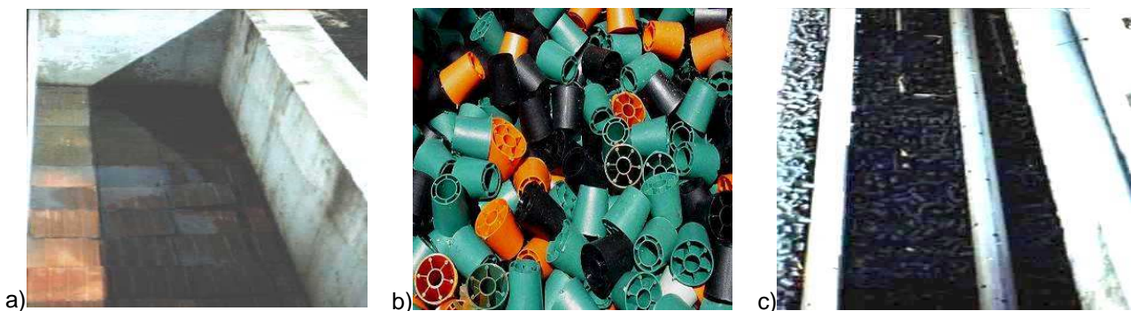
Figura 3.26: Materiais de enchimento dos filtros
