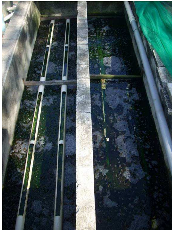
Figura 3.30: Lodo depositado nas canaletas de coleta e distribuição
