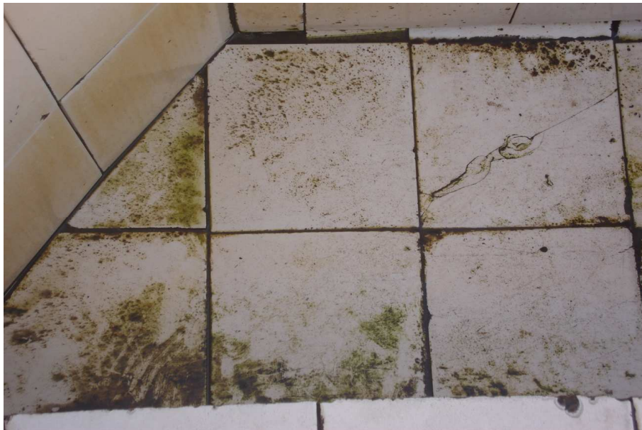
Figura 10 – Detalhe da parte interna do bebedouro mostrando a falta de higienização na “bica d’água” Santa Rosa, no Bairro Santa Rosa Município de Porto União – SC. Fonte: Acervo do autor, (2009).
