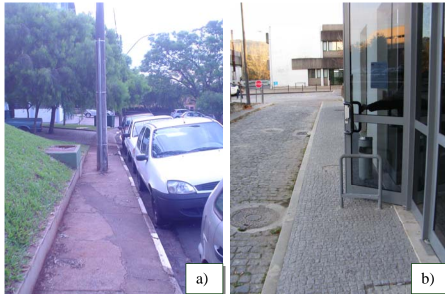
Figura 5.3: Exemplo de obstáculos que reduzem a largura efetiva das calçadas no campus de São Carlos (a) e no campus de Gualtar (b)
