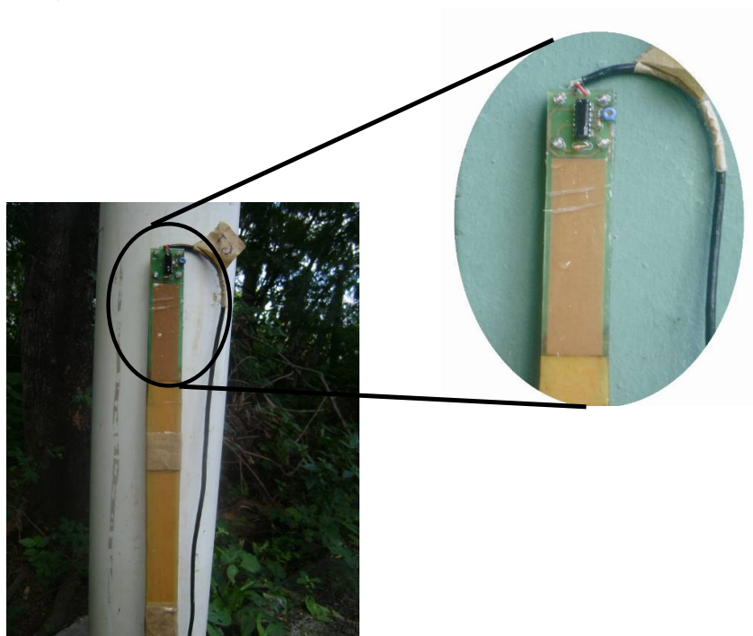
Figura 16 – Sensor capacitivo para monitoramento do nível de água na calha Parshall.
