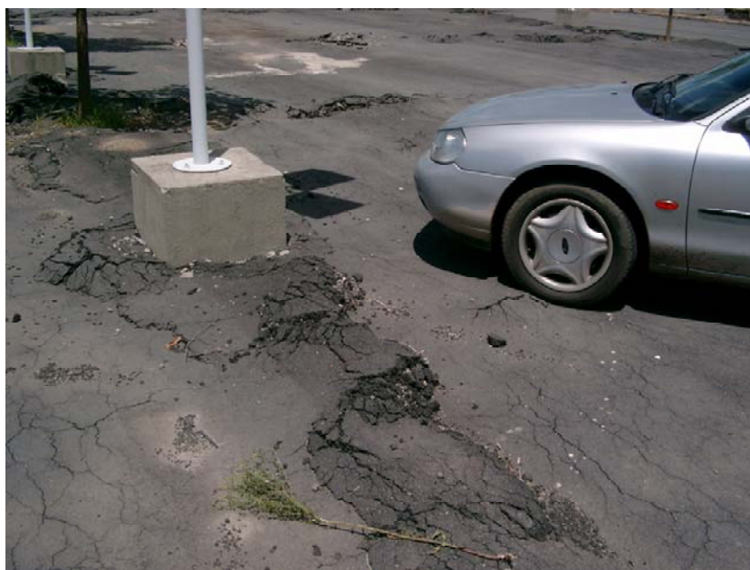
Figura 1.2 - Expansão causada pela escória de aciaria utilizada no pavimento do estacionamento de um hospital da região metropolitana de Vitória, ES
