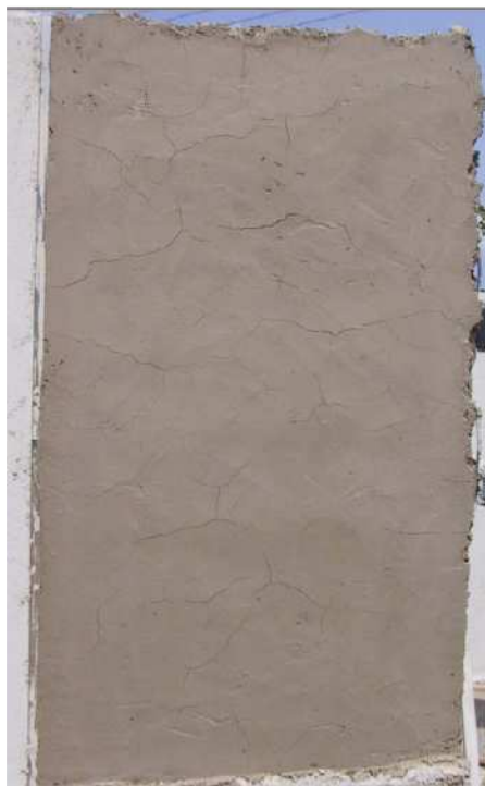
Figura 2.3: Fissuração apresentada pela argamassa com Saibro, logo após sua aplicação. Fonte: Projeto REFA – Avaliação do desempenho dos revestimentos de fachadas
