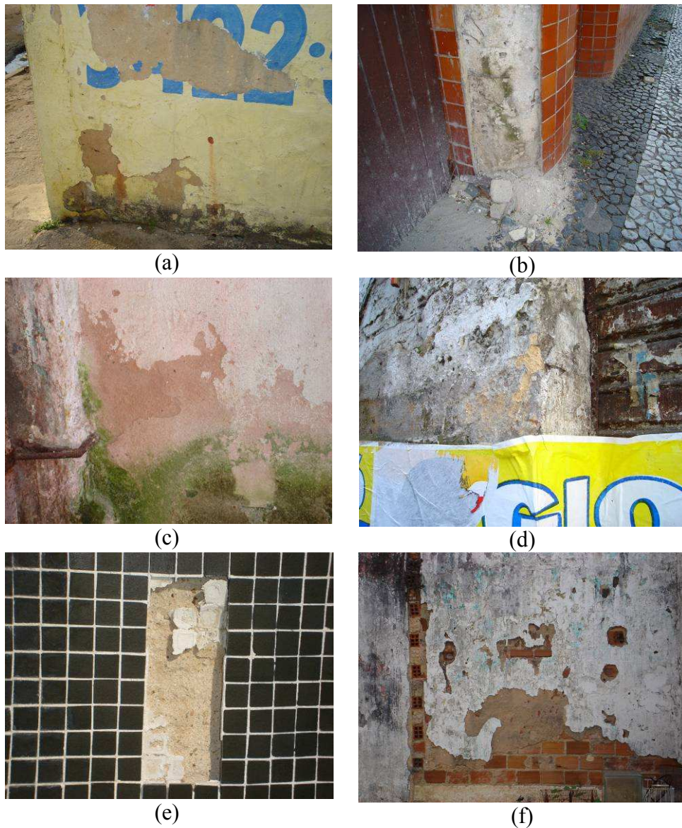
Figura 2.2: Algumas patologias das argamassas com Saibro. Fonte: Autor
