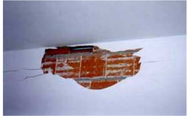
Deformação da estrutura por flexão
