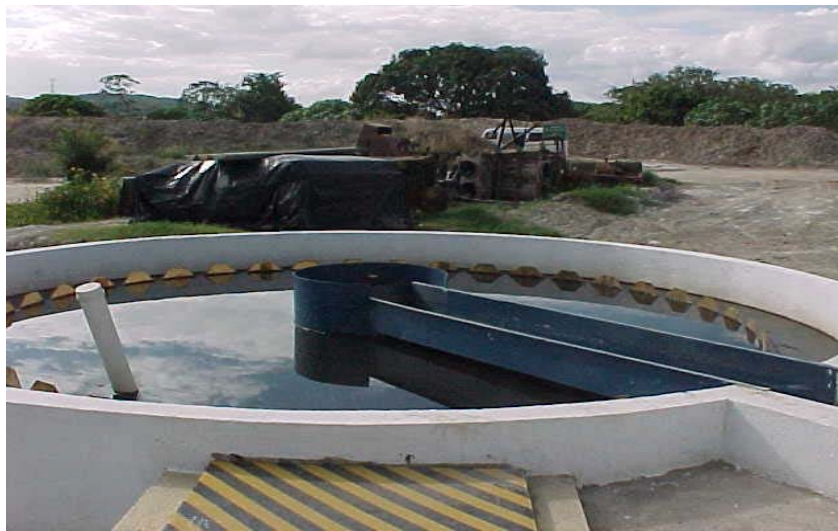
Figura 2.2 Decantador – Estação de Tratamento de Esgotos - ETE Curado.
