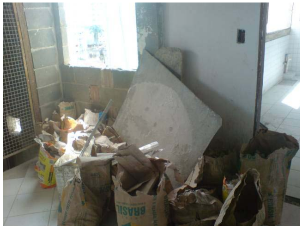
Figura 4.1. Acumulo de resíduos
