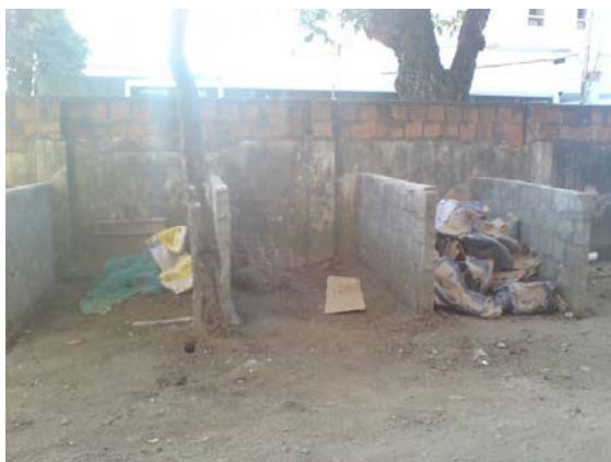
Figura 4.11 Baias sem cobertura e sem sinalização
