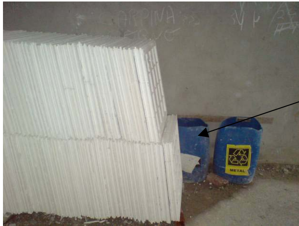
Figura 4.2 Bombonas mal localizadas e com sinalização inadequada
