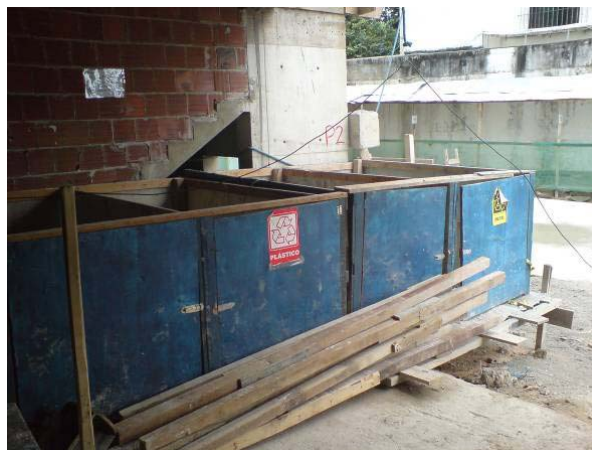
Figura 4.21 Baias sem sinalização
