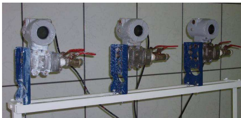
Figura 14: Medidores de pressão diferencial (SMAR).
