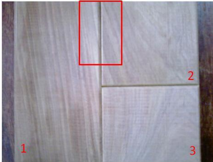
Figura 46 – Piso de ipê fora de esquadro
