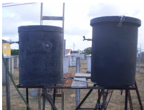
Figura 3.5. Reservatórios térmicos RT 150 e RT 200 do sistema de aquecimento solar estudado.
