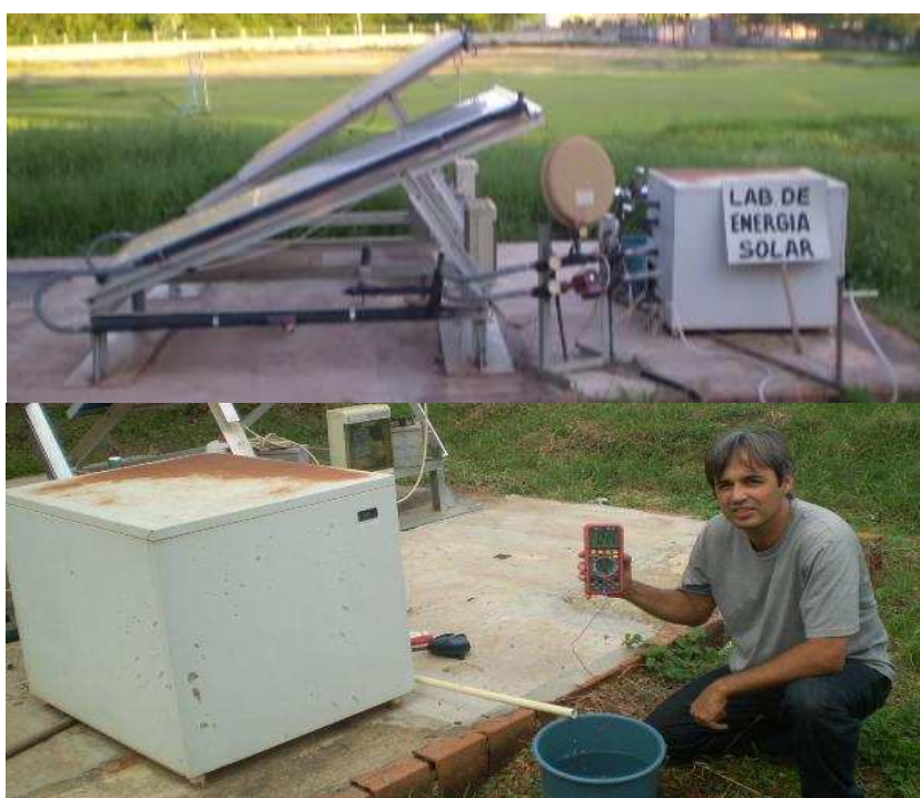
Figura 2.11. SAS de circuito indireto com seus componentes e controlador eletrônico de temperatura.
