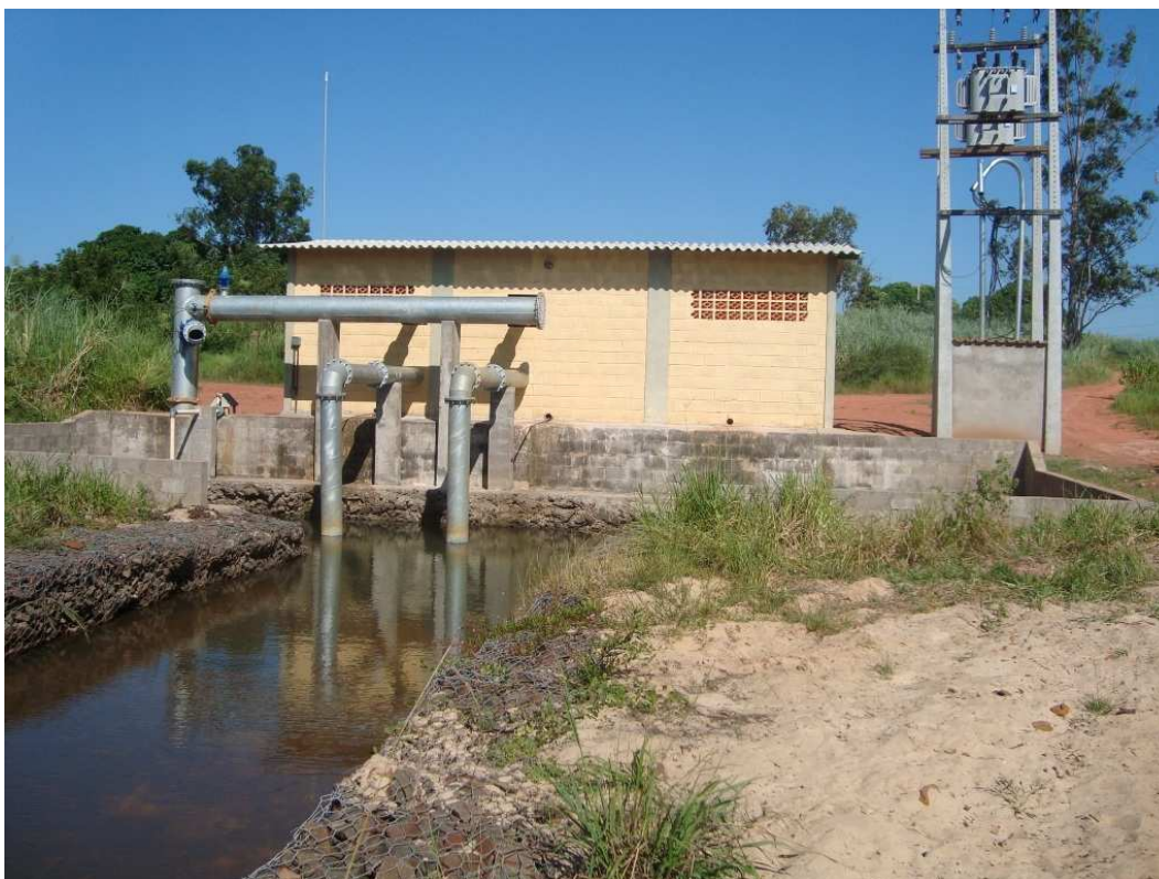
Figura 5. Sistema de captação e recalque inicial do sistema de fertirrigação para produção de madeira de Eucalyptus spp da Empresa MMX Metálicos Corumbá Ltda.
