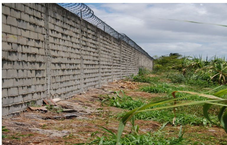
Figura 8. Muro da BAZF ao lado esquerdo do CRPU- vista pela Av. Borges de Melo.
