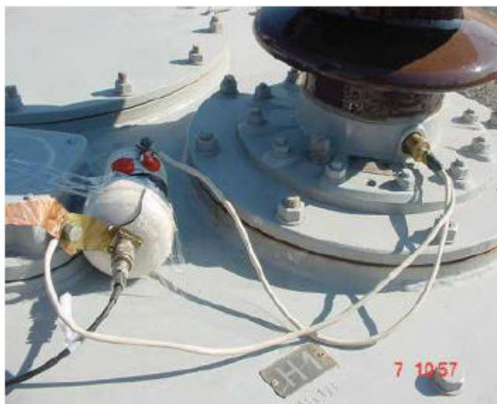
Figura 3.10 – Detalhe de unidade capacitiva de baixa tensão conectada ao tap capacitivo da bucha
