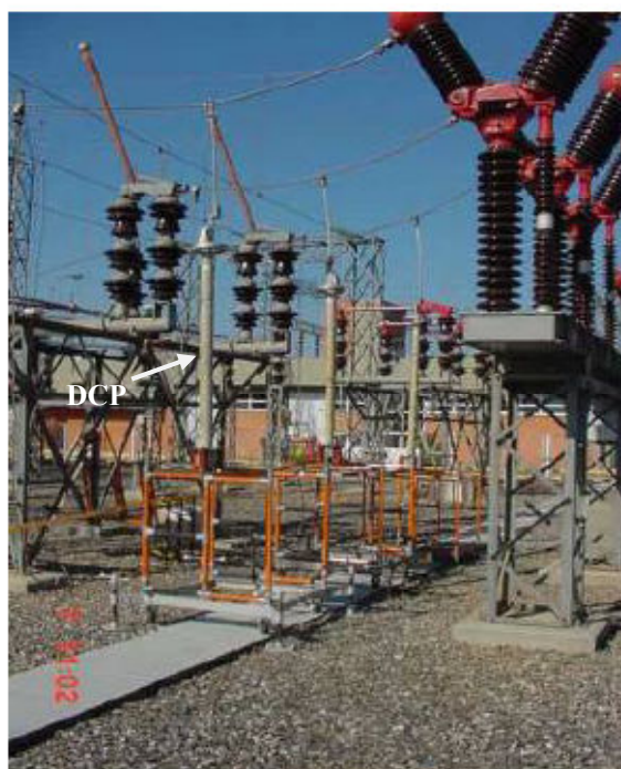
Figura 3.6 – Três unidades de Divisor Capacitivo de Potencial
