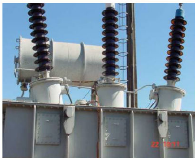
Figura 3.9 – Buchas de um transformador trifásico de alta tensão
