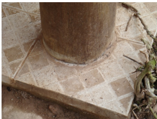
Figura 60 – Pilares em contato direto com o piso.
