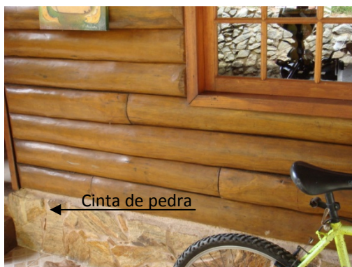
Figura 59 – Afastamento da parede em log do piso.
