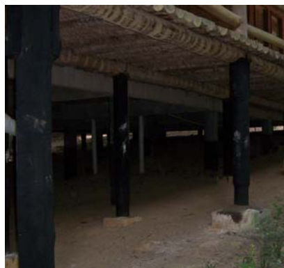
Figura 34 – Situação atual dos pilares do Centro de Vivência Ecoporanga.
