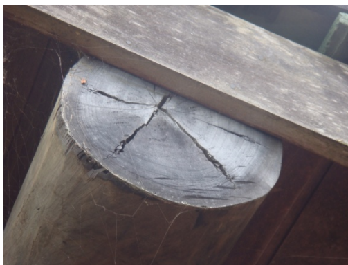
Figura 99 – Peça do telhado com fresta e acúmulo de umidade.
