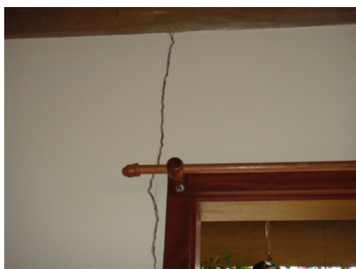
Figura 78 - Fresta vertical entre a viga de madeira e a alvenaria numa parede interna.
