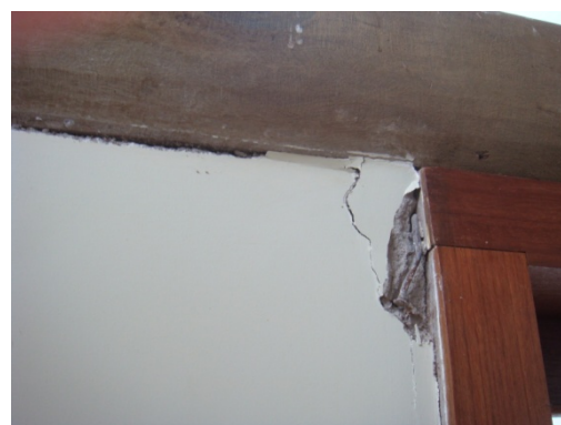
Figura 79 - Fresta no encontro da viga de madeira com a janela em uma parede interna.
