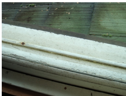
Figura 98 – Janela sem pingadeira e com acúmulo de umidade.
