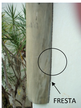
Figura 76 - Fresta entre madeira e alvenaria da parede externa.
