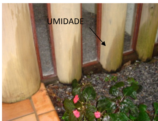
Figura 75 – Pilar com princípio de degradação devido ao acúmulo de umidade.
