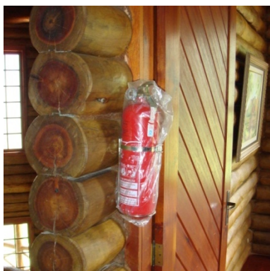
Figura 62 – Extintor de incêndio.
