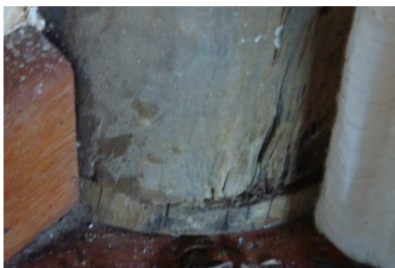
Figura 97 – Pilar estrutural com a base, aparentemente, cortada e em início de deterioração.
