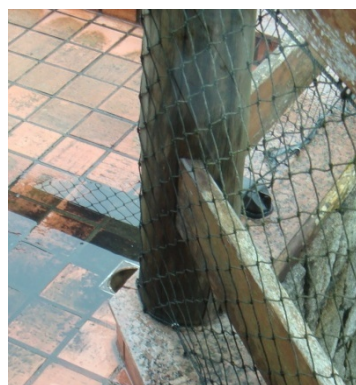
Figura 94 – Guarda-corpo de área descoberta com grande quantidade de umidade.
