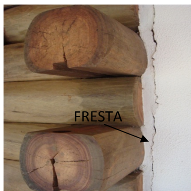
Figura 73 – Fresta entre a madeira e a alvenaria.
