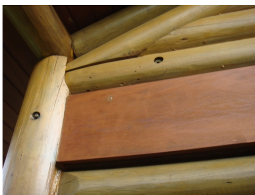
Figura 87 – Espaçamento coberto por prancha de madeira.
