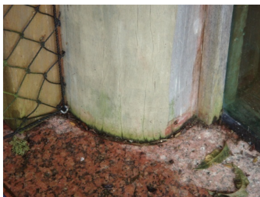
Figura 93 – Pilar estrutural com acúmulo de umidade na base.
