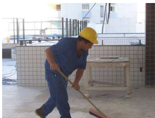
Figura 5 – Funcionário varrendo o chão sem EPR e sem umedecer o piso
