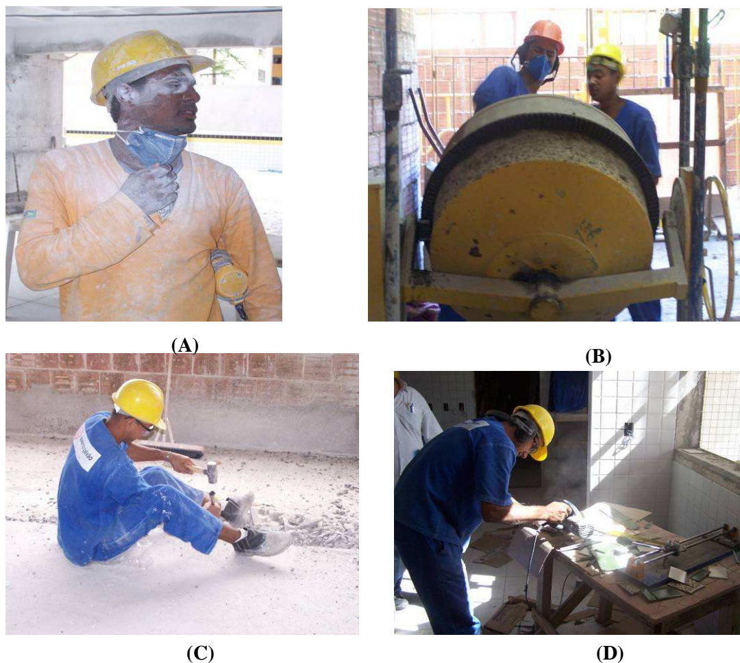
Figura 7 – Situações não conformes quanto ao uso de EPR
