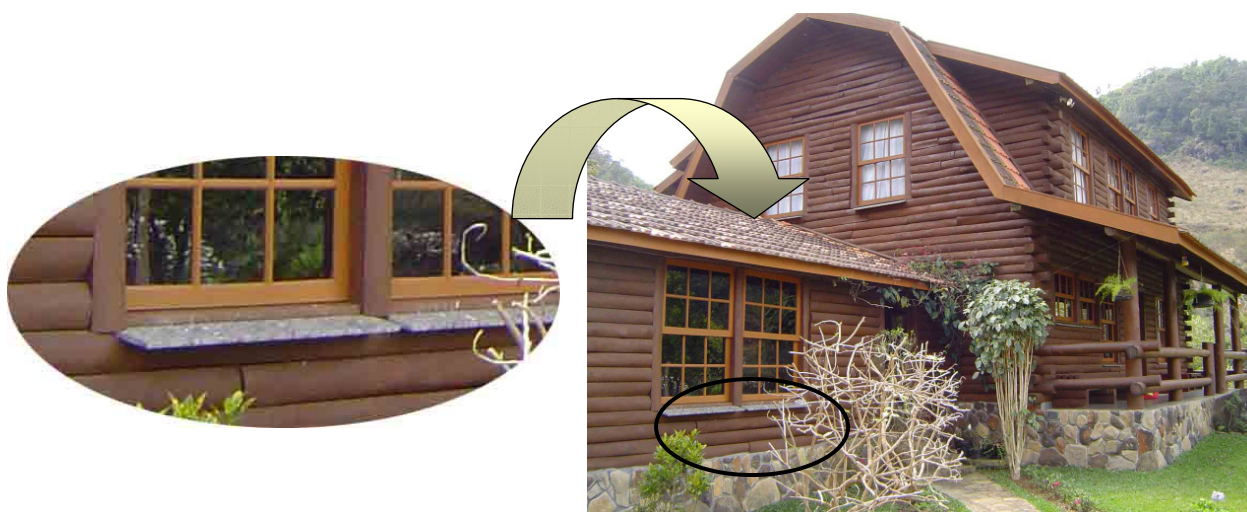
Quadro 5. 1: Levantamento técnico – principais problemas observados na casa em Piaçu
