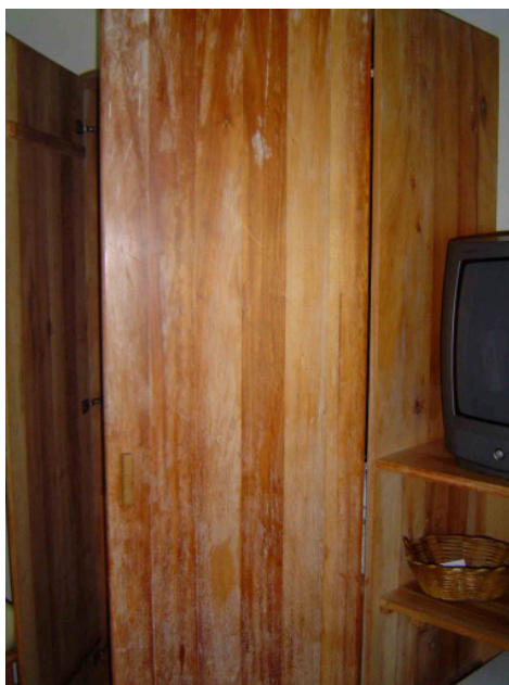
Figura 5. 15: Alteração na superfície externa do mobiliário do apartamento, característica da presença de umidade
