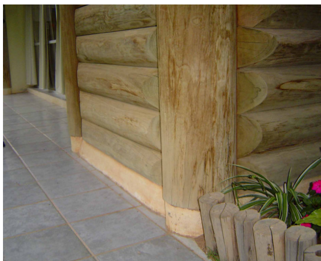
Figura 5. 11: Detalhe da fachada da creche que mostra o aspecto causado pela falta do hidrofugante
