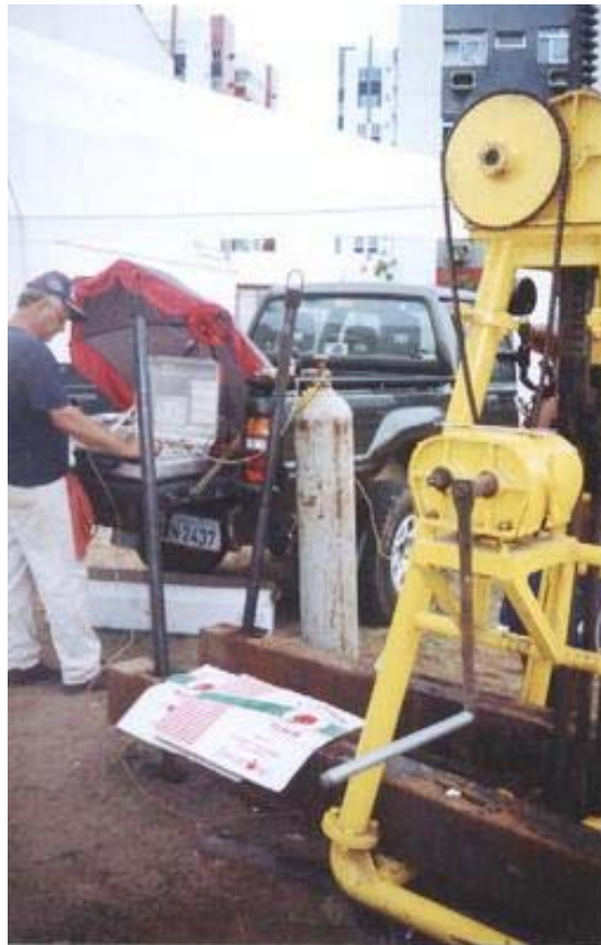
Figura 4.6: Execução do ensaio DMT usando o sistema de reação e hastes do CPT
