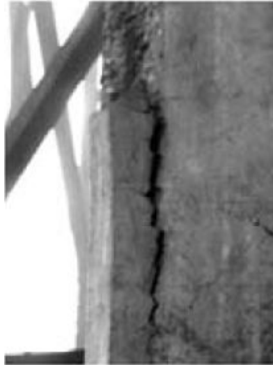
Figura 3.27 – Spalling em um pilar de concreto armado.
