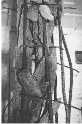
Figura 3.28 – Spalling em um pilar de concreto armado.
