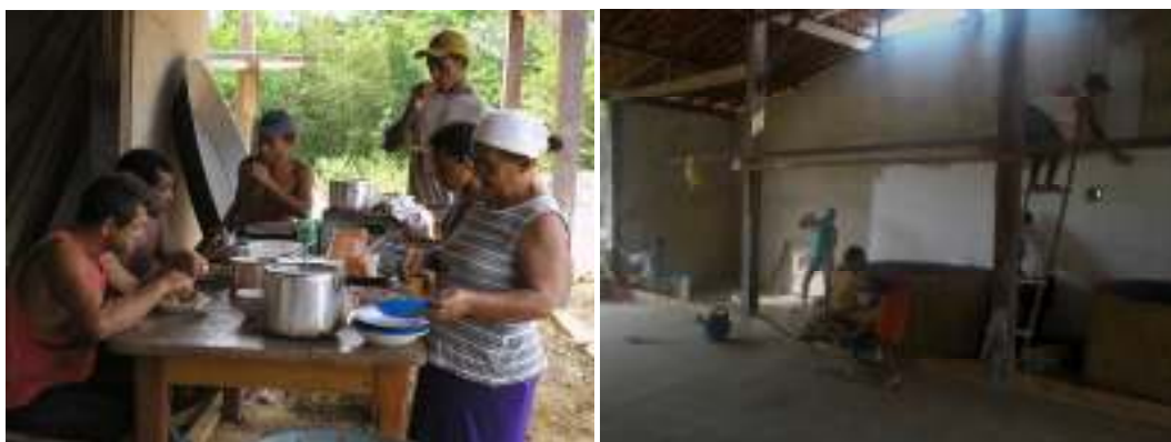
Figura 27 e 28. Hora do almoço dos trabalhadores da obra da Casa de Farinha. E trabalho de mutirão na Casa de Farinha. Fonte: Arquivo de Patrícia Mendes
