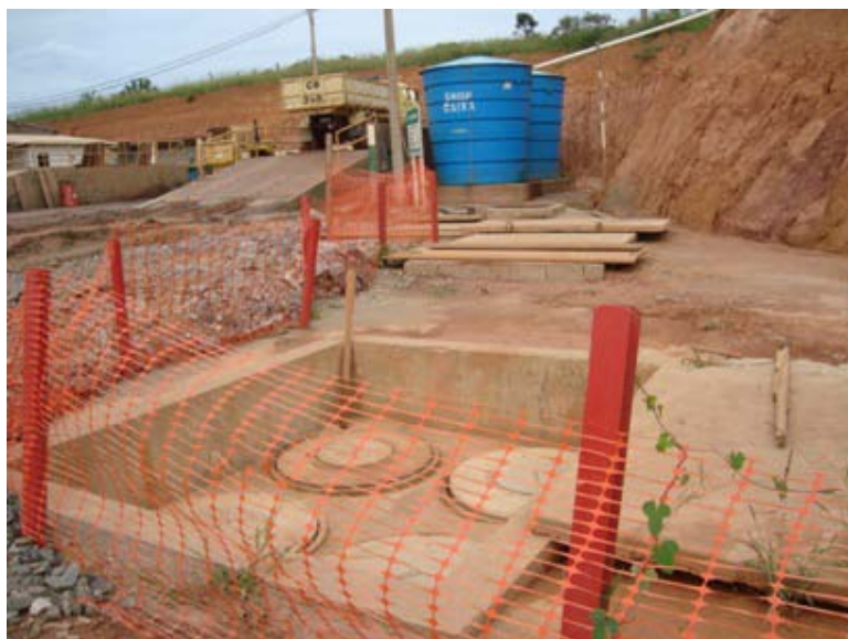
Figura 26: Sistema separador de água e óleo da Oficina Mecânica/Rampas de lavagem
