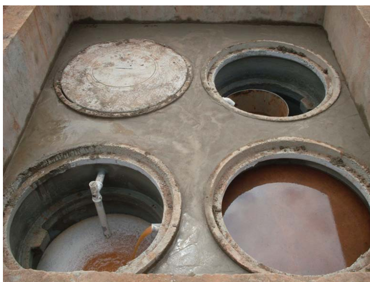
Figura 27: Detalhe das caixas separadoras de água e óleo
