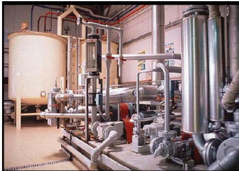
Figura 2.3 – Foto de instalações de uma fábrica de produção de emulsão asfáltica (adaptado de Nascimento, 2005).
