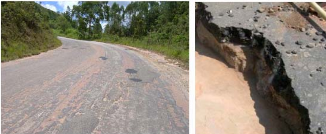
Figura 2.8 – Trecho antigo de solo-emulsão na RJ 148 no estado de Rio de Janeiro cerca de 20 anos após construção (THULER , 2005).
