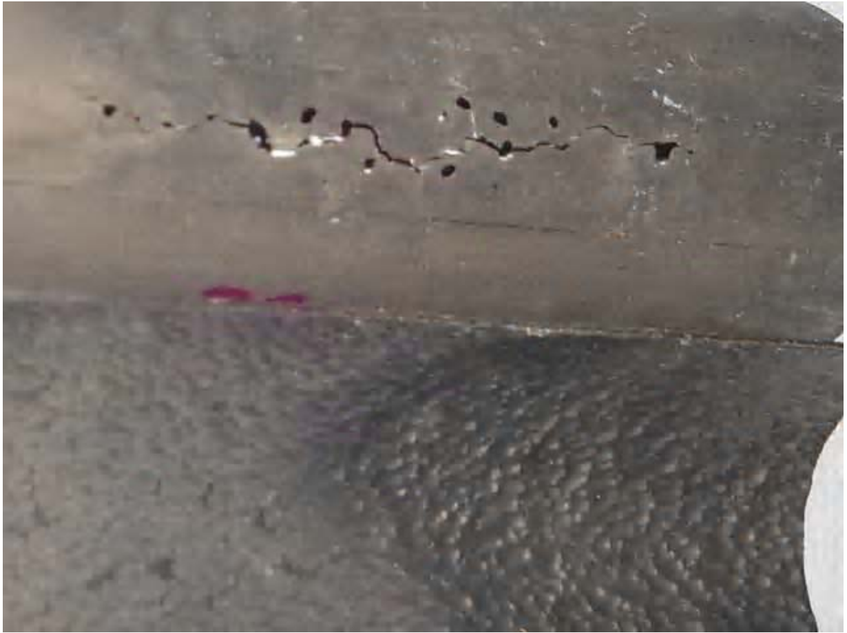
Figura 2.10 – Tubo do trocador de calor do 1º efeito da A-328 que apresentou processo de formação de pites generalizados ocasionando furos.
