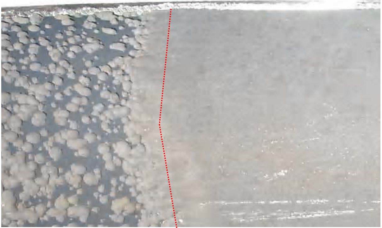
Figura 2.13 – Vista em detalhe da figura 2.12. A linha pontilhada mostra o ponto de maior degradação do tubo, localizado abaixo da luva.
