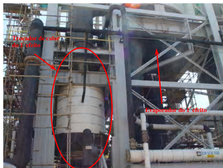
Figura 2.2 – Vista em detalhe da posição operacional do trocador de calor do 1º efeito da A-228.
