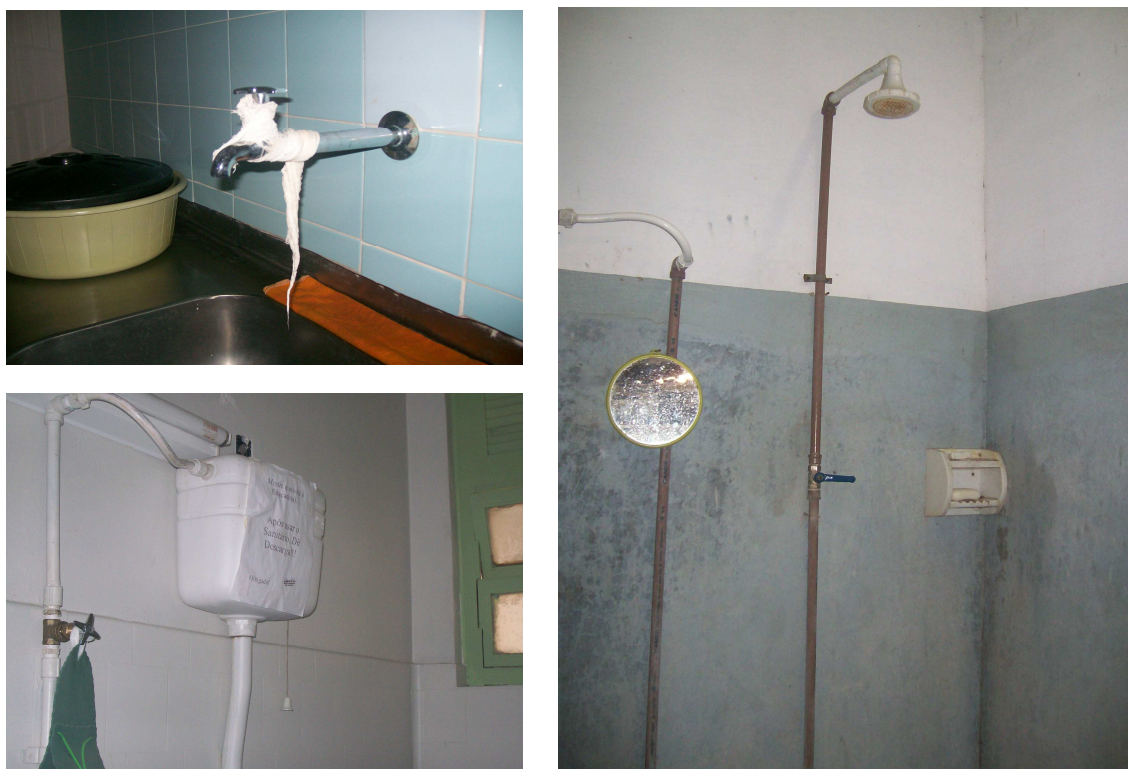
Figura 31 – Aparelhos convencionais instalados no HUAC.
