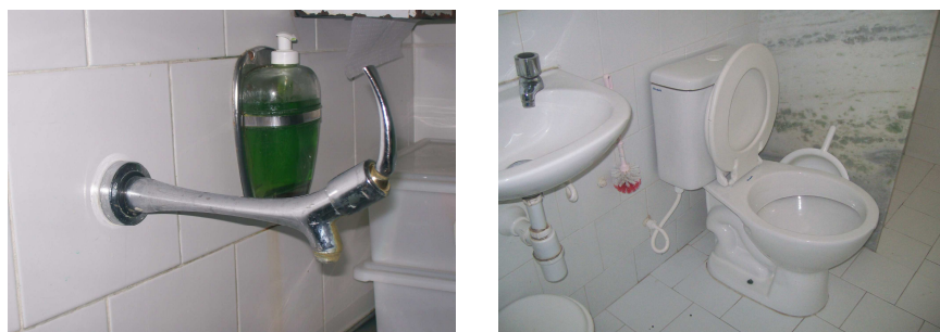
Figura 32 – Aparelhos economizadores de água instalados no HUAC (torneira com alavanca e bacia sanitária com caixa acoplada de 6 litros/acionamento).
