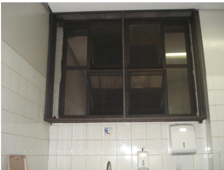
Foto 7 – Janela aberta com tela de proteção (H2)
