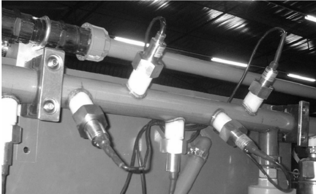
Figura 3.51: Uso de sensores térmicos para controle do transporte de pasta mineral. (Ilgner, 2005)
