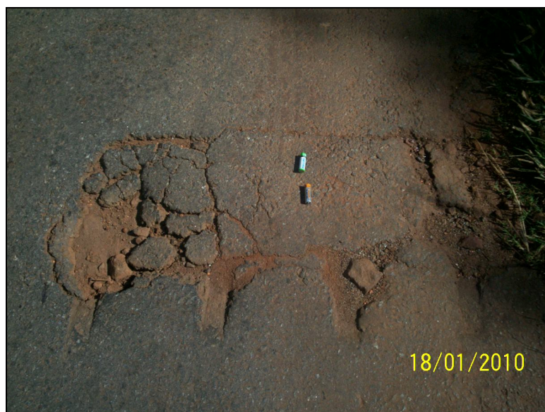
Figura 6.27 – Detalhe da panela provocada por maquinário local.
