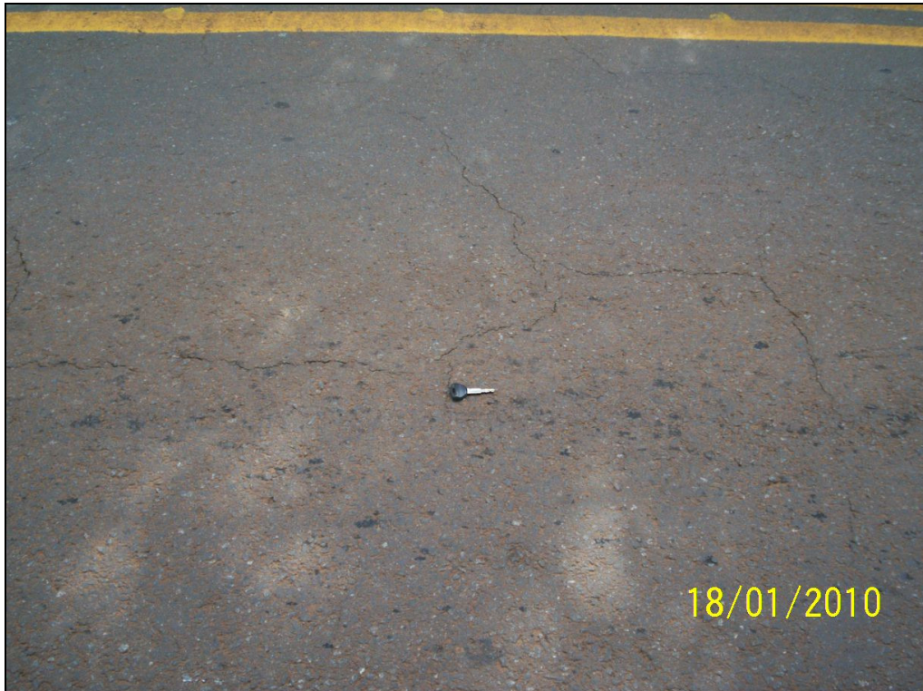
Figura 6.56 – Detalhes das trincas no sub-trecho solo+pó de micaxisto
